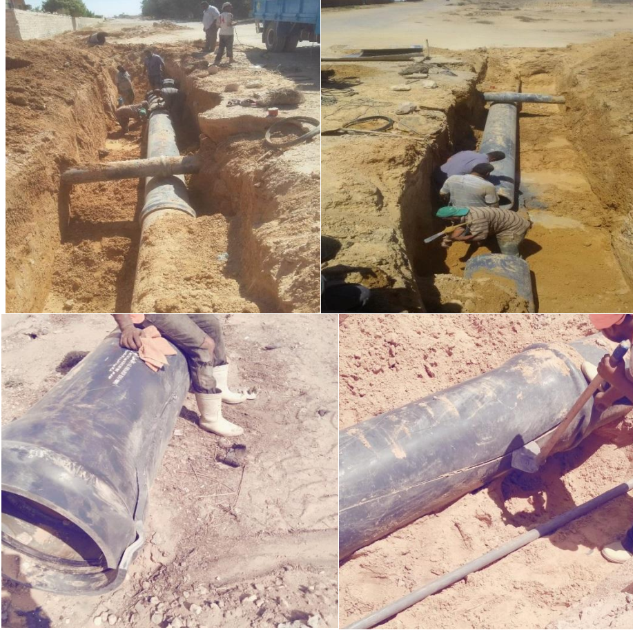
شكل (2) إصلاح تلف رأس فى ماسورة بلاستيك 500 بتركيب ماسورة برأس وكاوتش جهة الرأس وجيبولت واحد فقط فى الجهة الأخرى
