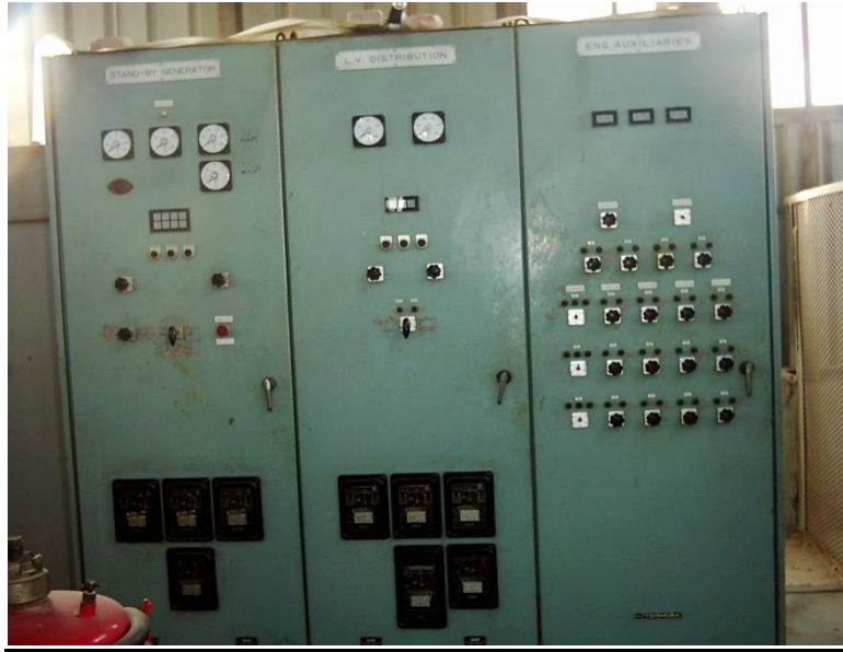
الشكل يوضح لوحه كهربائية داخل مبنى
