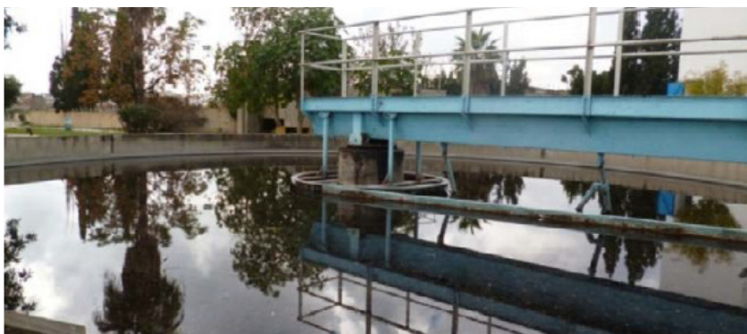
الشكل 3 : المرسب الثانوي في محطة الوردانين لمعالجة مياه الصرف الصحي WWTP Ouardanine (بتصريح من محجوب 2015) (with permission of O. Mahjoub 2015).
